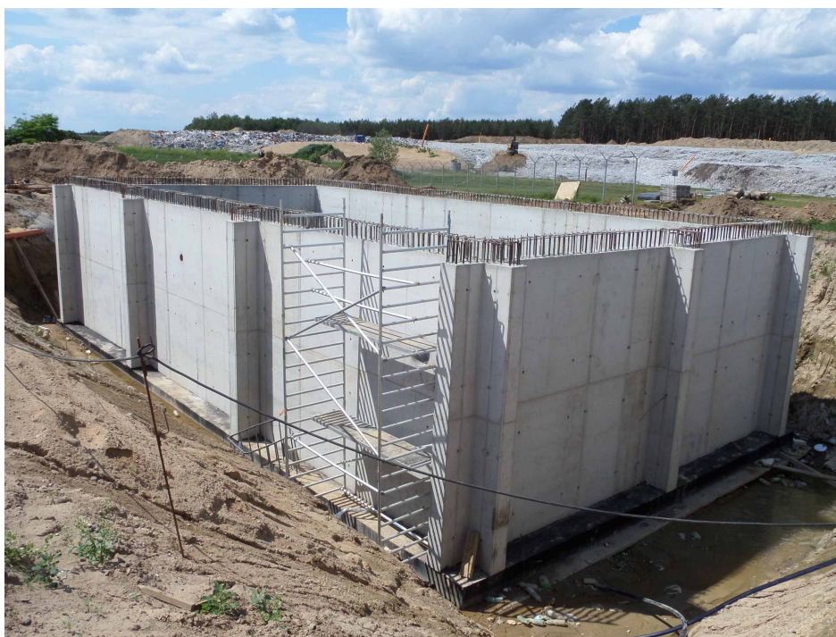
Zbiornik na wody deszczowe wykorzystywane do procesów stabilizacji
